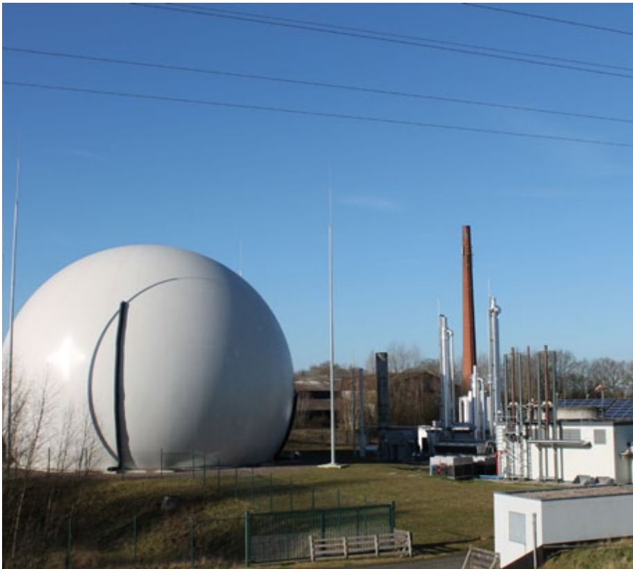
Biogasaufbereitungsanlage in Coesfeld-Höven.
