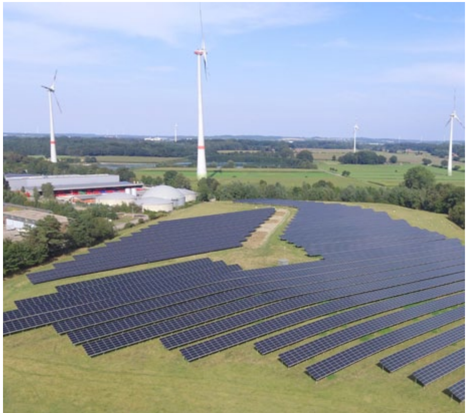
Photovoltaik-Freiflächenanlage auf der ehemaligen Deponie in Coesfeld-Flamschen.
